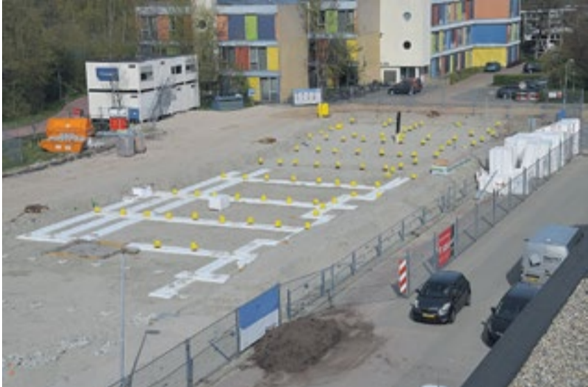
Aan de bottelroosstraat is een deel van de fundering inmiddels gelegd, foto Hans Mulder
